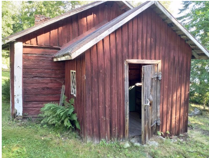
Kuva. Kuvia huonokuntoisesta rakennuksesta tilalla 5:270, jonka SR-merkintä poistetaan.
