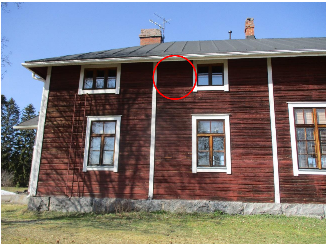
Kuva 1 Vaurio on pistemäinen ja sen aiheuttaja on vanha kattovuoto.
