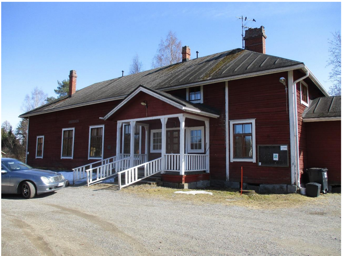
Kuva 4 Pääsisäänkäynnin oikealla puolella eli lännen puolella ei ole syntynyt vaurioita alimpiin hirsikertoihin.
