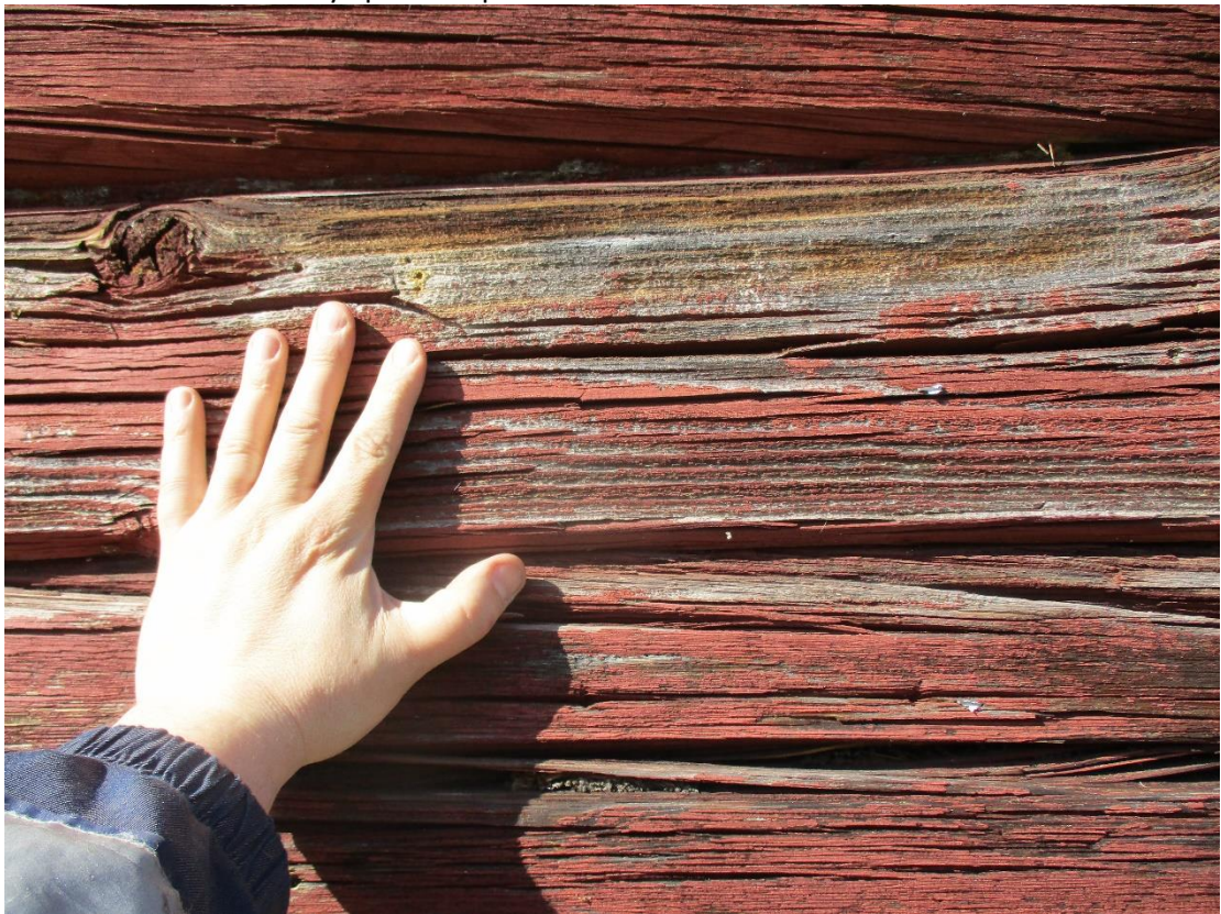
Kuva 3 Rakennukseen kannattaa asentaa ulkovuoraus, jotta haristuneiden hirsien pintoihin ei ala syntyä lahovaurioita. Kyseessä on vaurioitumista ehkäisevä toimenpide.
