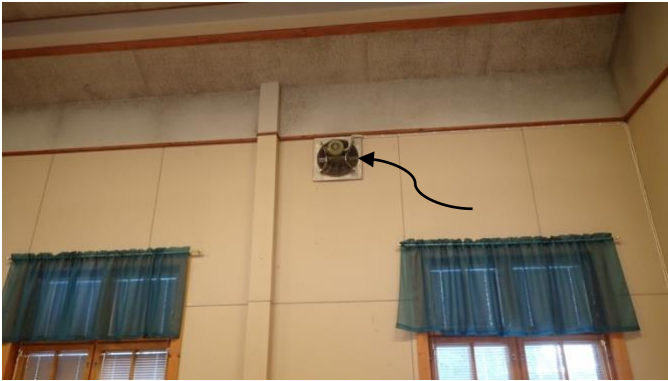
1. Ilmanvaihdon poistoa voidaan tehostaa poistopuhaltimilla.
