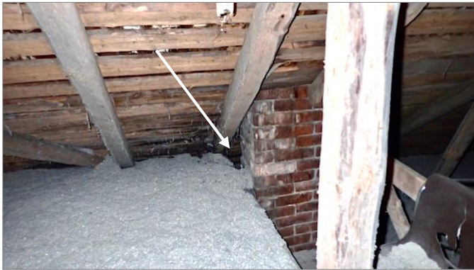
3. Vesikaton alapuolisten rakenteiden vaurioita yläpohjassa.
