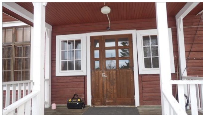
7. Ulko-ovilla peruskorjaus- ja uusimistarvetta.
