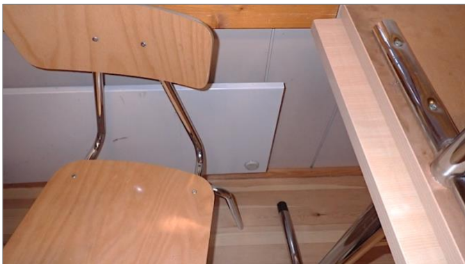
1. Sähköpattereiden tekninen käyttöikä on ylittynyt.
