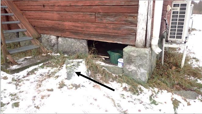
1. Kaakkoisnurkalla perustuskivi on irronnut ja kaatunut.
