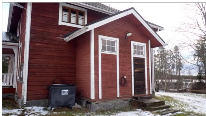
2. Kuistien osalla vain kourut, vedet rasittavat julkisivuja.
