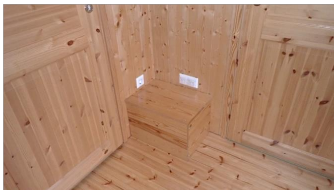
1. Päävesiputki tulee sisään rakennukseen eteisaulassa.
