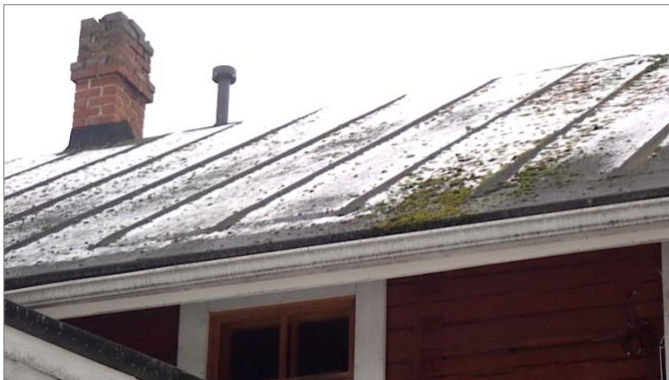
5. Huopakatteella sammalkasvustoa, läpiviennit epätiivittä.
