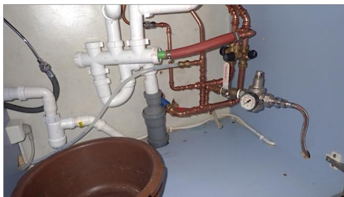
2. Käyttövesi- ja viemäröintiosia keittiössä, kuparia ja muovia.
