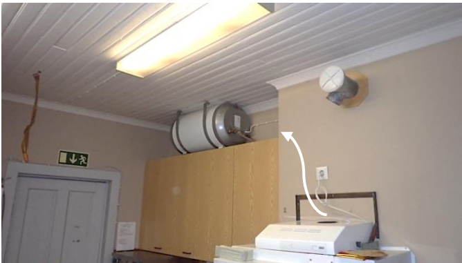
1. Keittiön liesituulettimen poisto puutteellinen.
