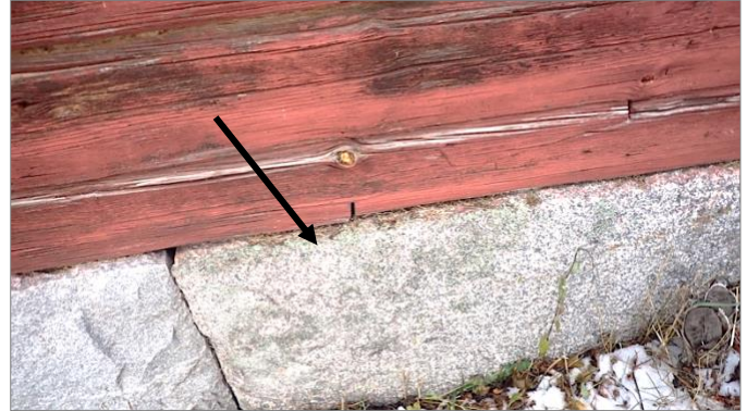
2. Perustuksella on noin 50 mm:n seinälinjan ylitys.
