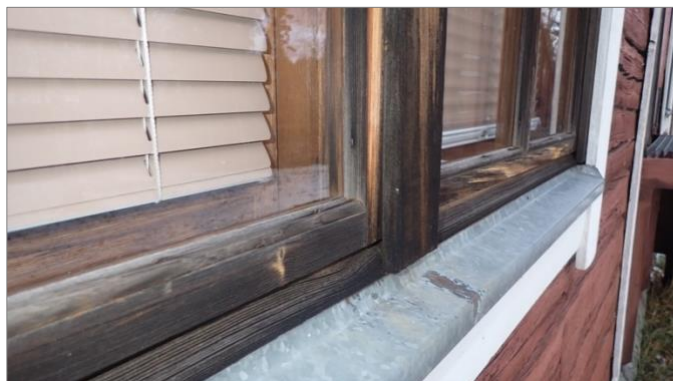
6. Ikkunoilla peruskorjaustarvetta, ulkopuitteet uusittava.
