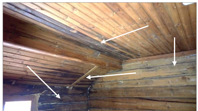
2. Yläpohjan ja ulkoseinän lahovaurioita asunnon osalla.
