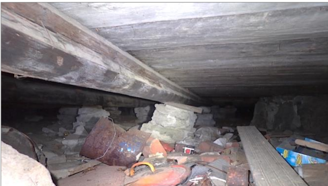
3. Ryömintätilaa itäpäädyn alueella, runsaasti jätettä.
