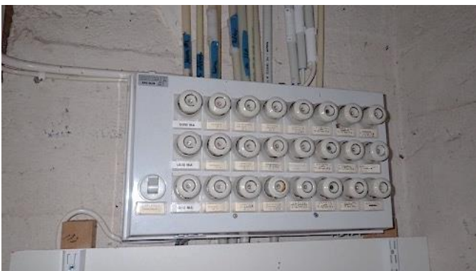
3. Alakeskus eteisaulassa, ei merkittäviä puutteita.
