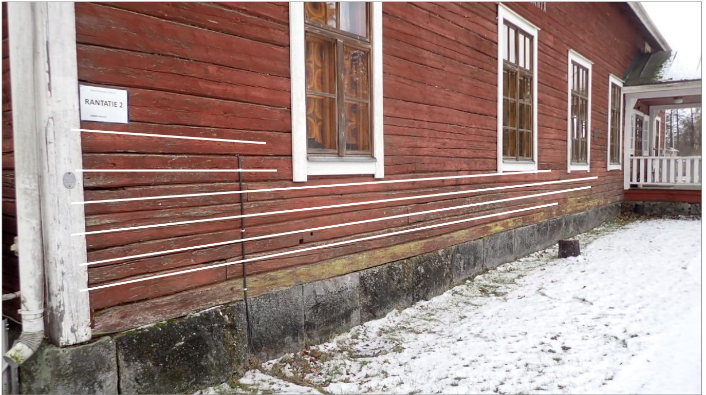
Kuva 1. Pohjoissivulla laajasti lahovaurioita, hirret on uusittava vaurioiden korjaamiseksi. Julkisivut kartoitettava kokonaisuutena.
