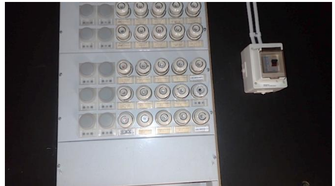
2. Pääkeskuksen vieressä ulkorasioiden vikavirtasuojaus.
