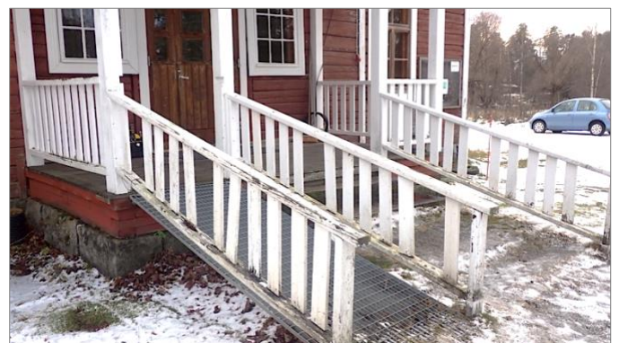
5. Pääsisäänkäynnin kuisti peruskorjauksen tarpeessa.
