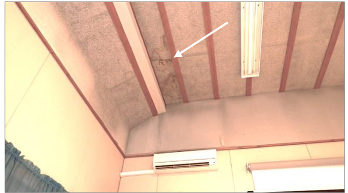
4. Vesikaton vuotojälkiä salin sisäkatoissa, rakenteilla vaurio.
