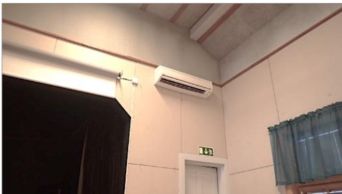
3. ILP-sisäyksiköt levittävät hyvin lämmintä ilmaa tiloihin.
