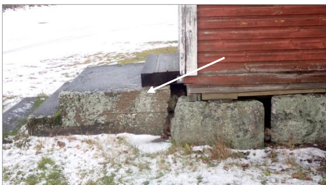
4. Länsipäädyn kuistin perusrakenteet painuneet.
