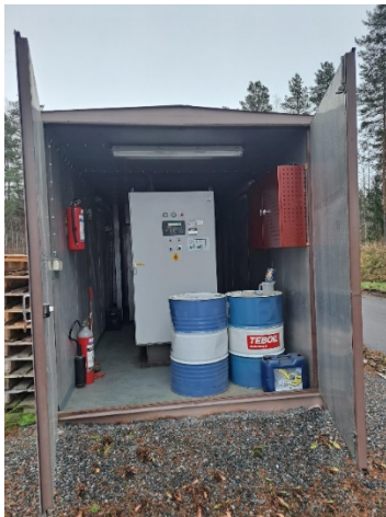
Varavoimakontti, jossa 400 litraa polttoöljyä.
