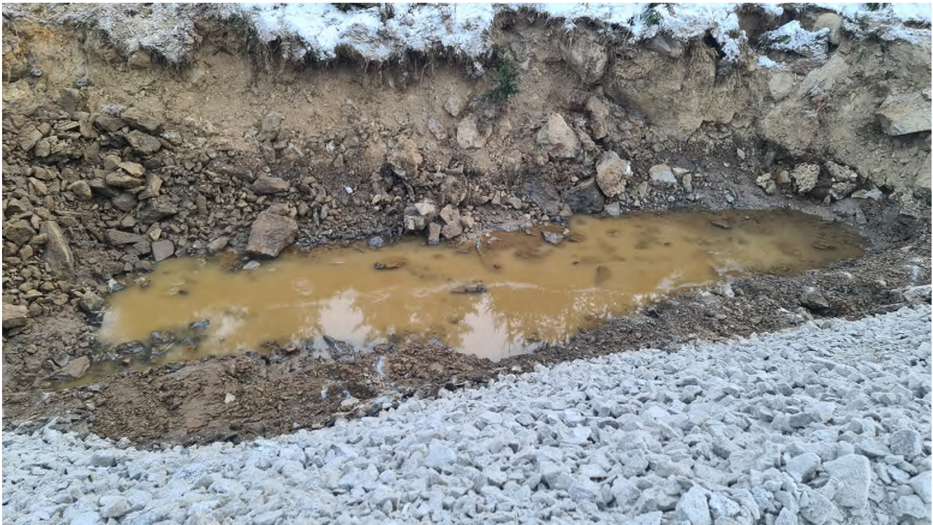
Kuva 7 Kaivantoon kerääntyi imemisen jälkeen hieman vettä. Vedessä ei ollut öljyn hajua tai tummempia alueita. Kuva otettu 13.12.2024.
