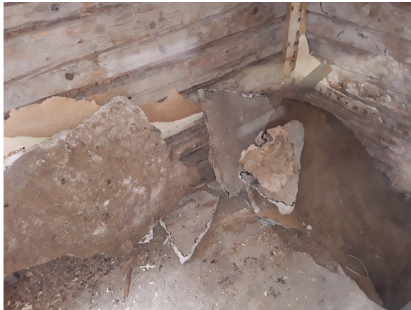
alapohja viemärin kohdalta romahtanut
