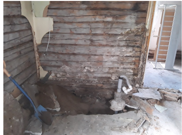
seinissä vaurioita yli metrin korkeuteen
