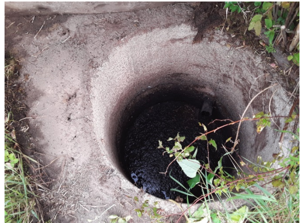
kiinteistön oma imeytyskaivo
