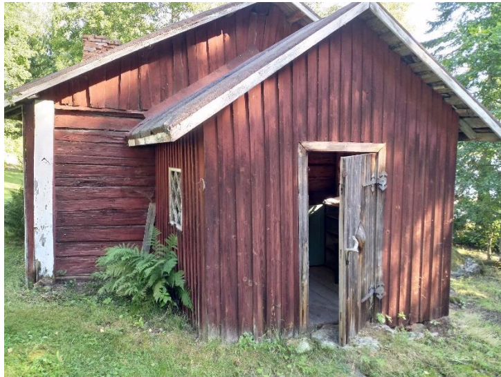
Kuva 10. Kuvia huonokuntoisesta rakennuksesta tilalla 5:270, jonka SR-merkintä poistetaan.
